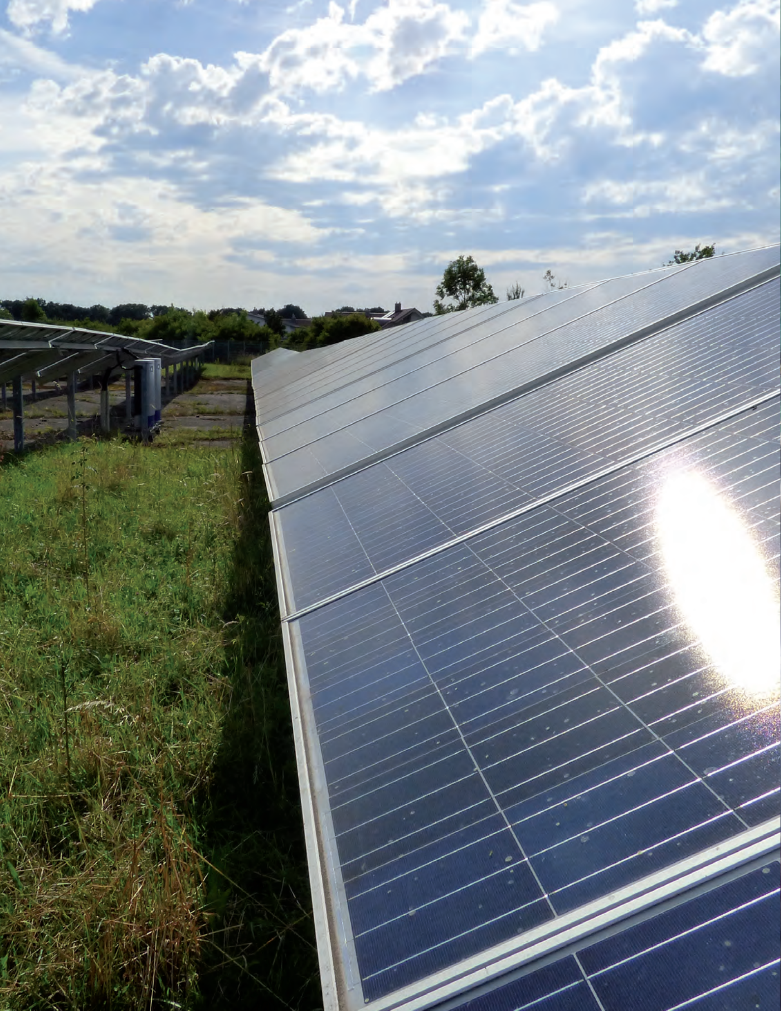
Photovoltaikanlage auf der Mutlanger Heide
