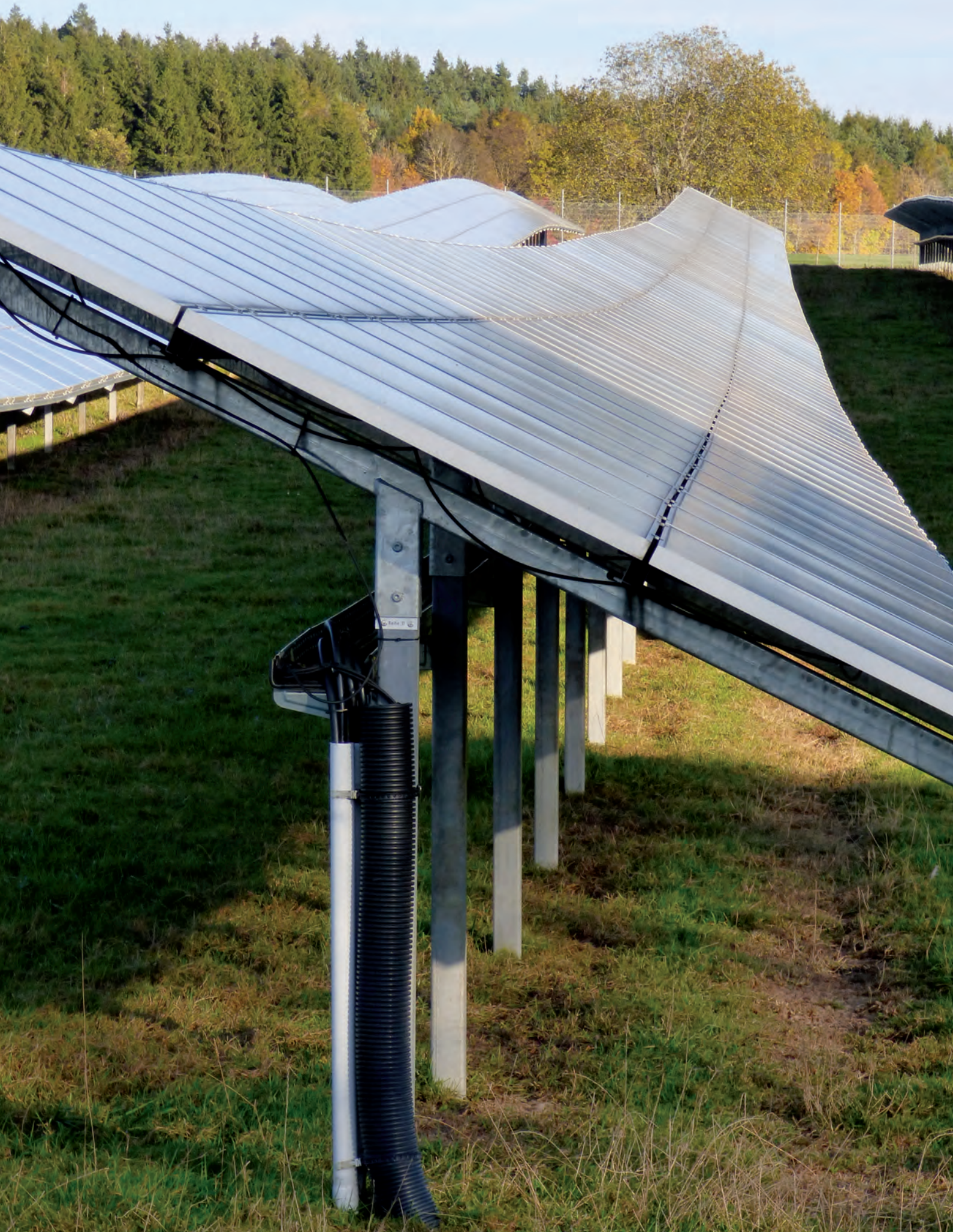
Freiland-Photovoltaikanlage bei Rottweil
