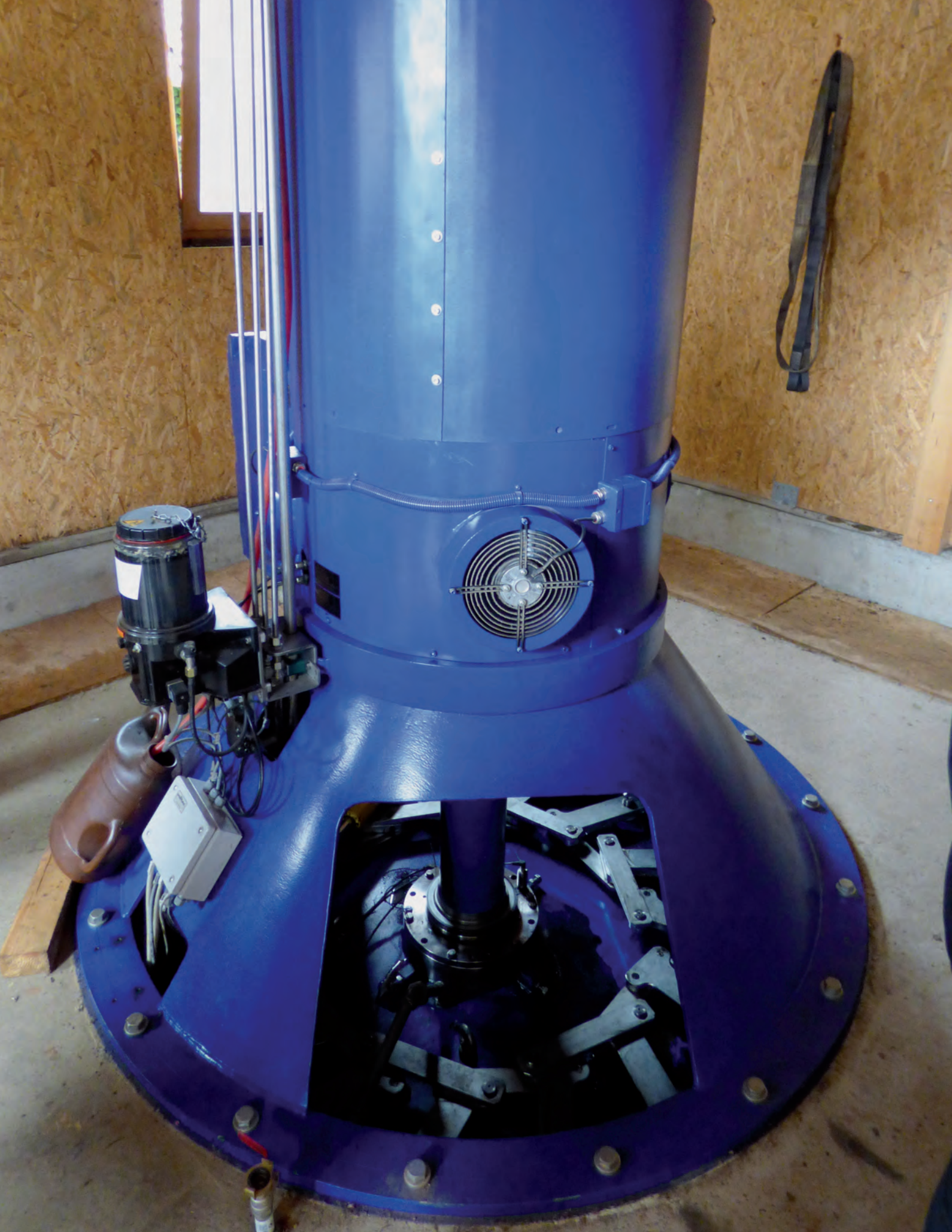
Doppelt geregelte Kaplanmaschine einer kleinen Wasserkraftanlage im Schwarzwald
