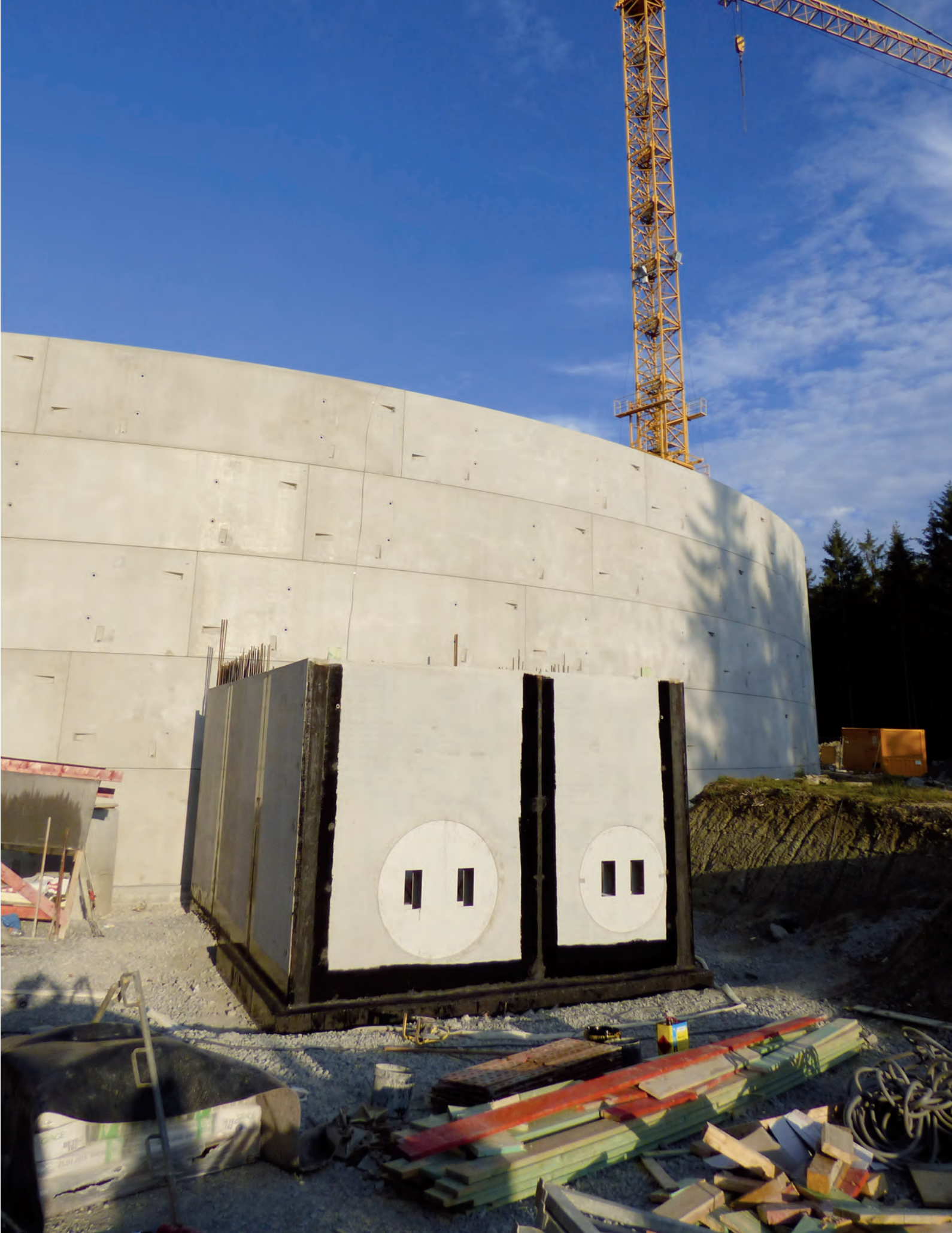
Wasserspeicher für Windenergie bei Gaildorf
