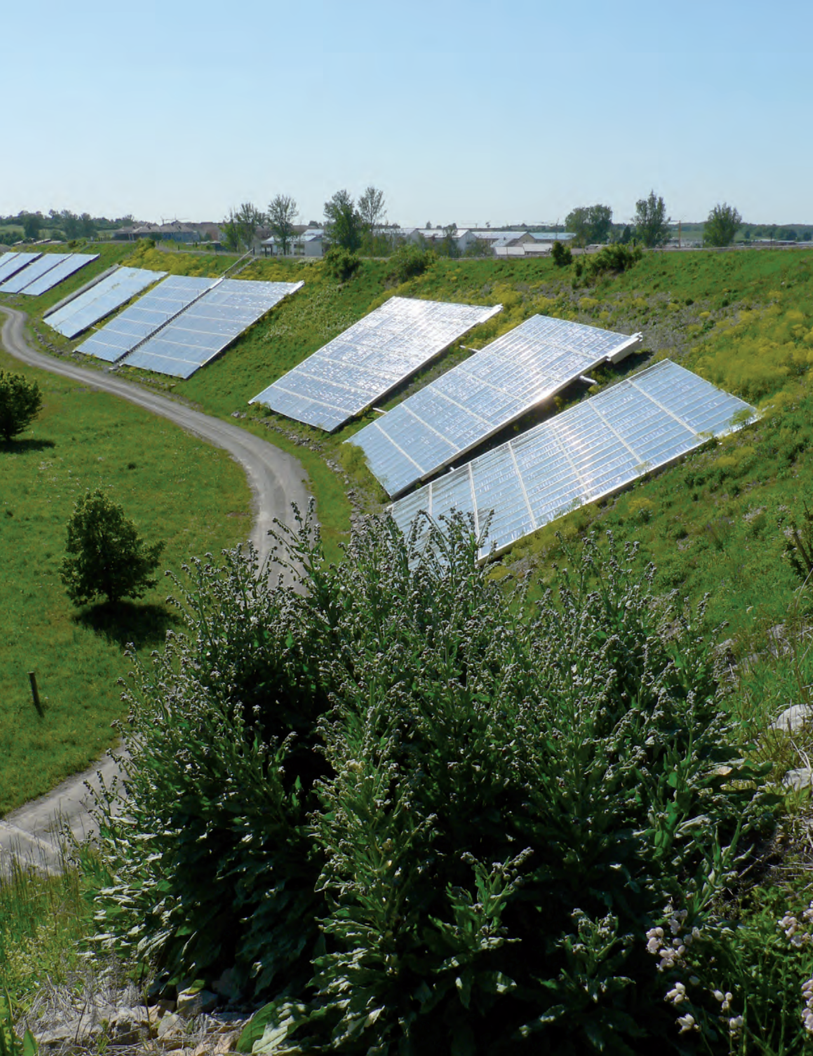
Solarthermische Großkollektorfelder in Crailsheim
