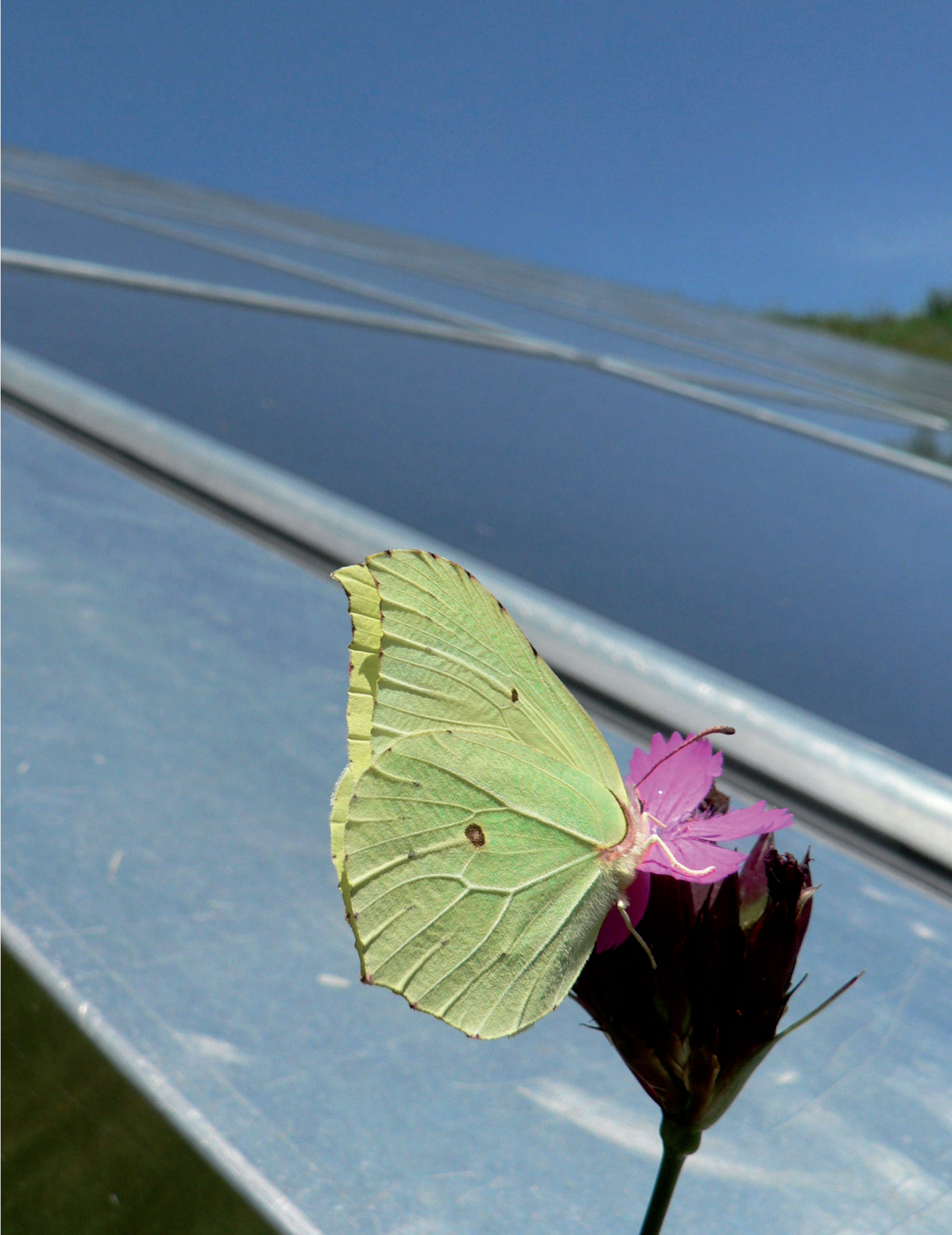
Großes Kollektorfeld für solarthermische Anlage in Crailsheim
