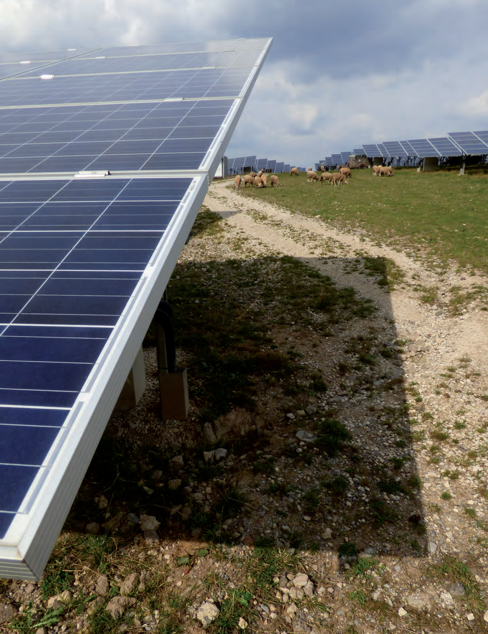
Freiland-Photovoltaikanlage bei Lutstrut
