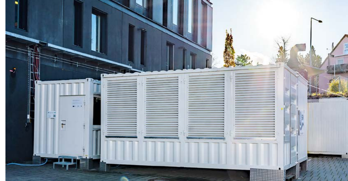
Containerintegrierte skalierbare DAC-Anlage mit einer jährlichen Abscheidkapazität von 100 Tonnen CO 2 .
