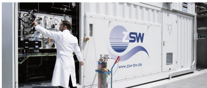
Innovatives Knowhow im Container: Die Elektrolyse-Anlage am ZSW. Foto: © ZSW
